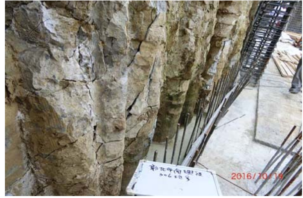
南側預壘樁擠壓、變形及破碎
